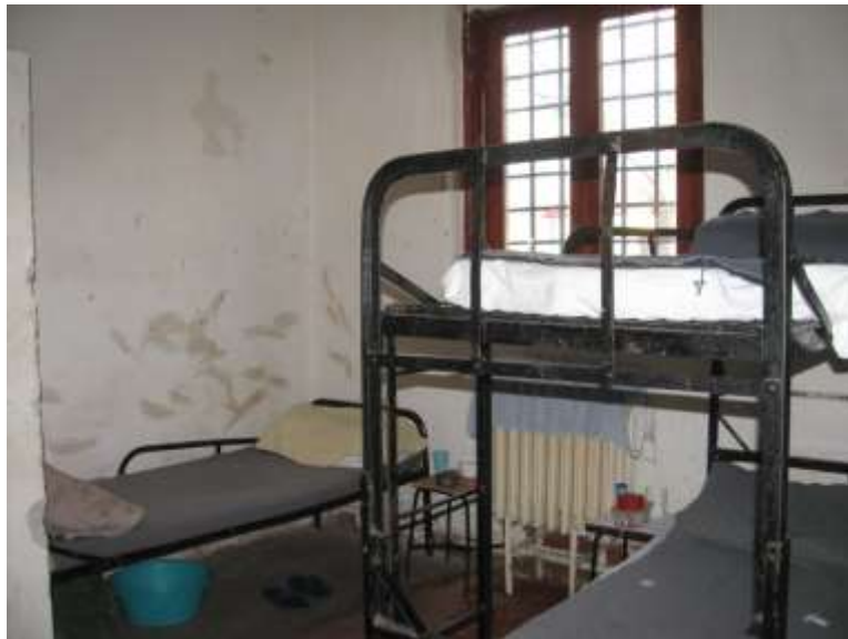
5. Zárkabelső a Solti Objektumban
